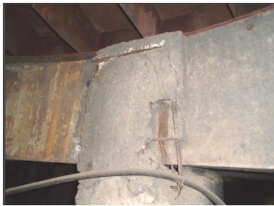
Рис. 5 Найбільш характерні пошкодження кільцевих балок
