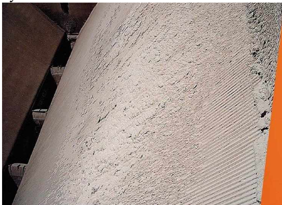
Рис.4. Утворений шлак в топці котла
