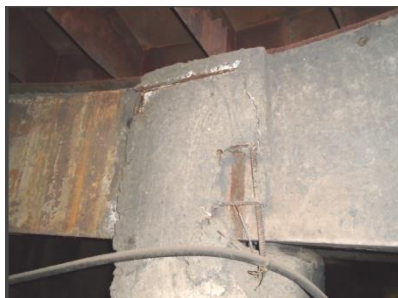
Рис. 5 Найбільш характерні пошкодження кільцевих балок
